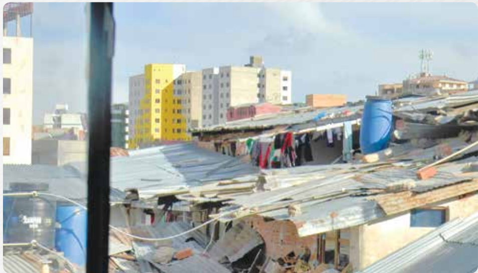
▶ Precario almacenamiento de agua, Centro Penitenciario de San Pedro de La Paz.
