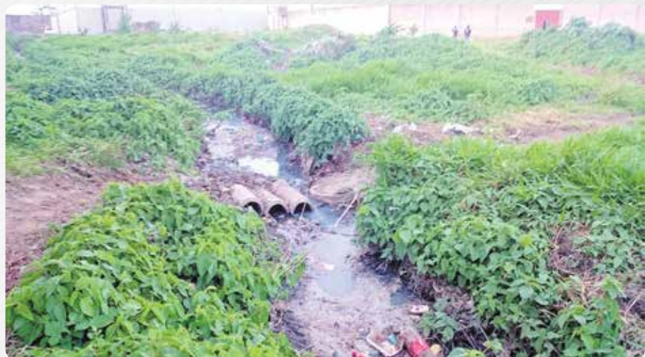
► Sistema de alcantarillado y desagüe, Centro de Rehabilitación Santa Cruz - Palmasola.
