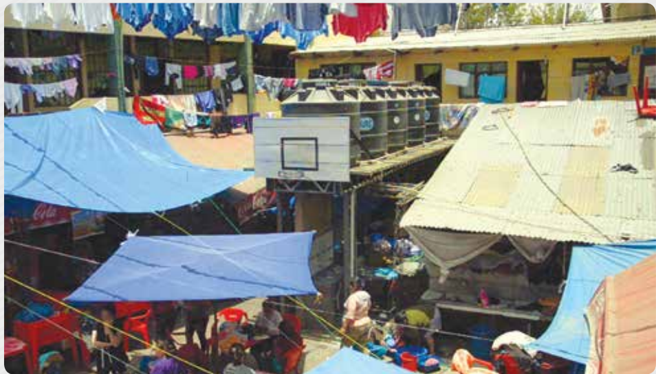
▶ Almacenamiento de agua en tanques, Centro Penitenciario de San Sebastián, Cochabamba.
